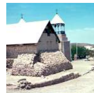
Observamos una historia sísmica del templo donde la comunidad intuitivamente fue adosando refuerzos para evitar su colapso (contrafuertes).
