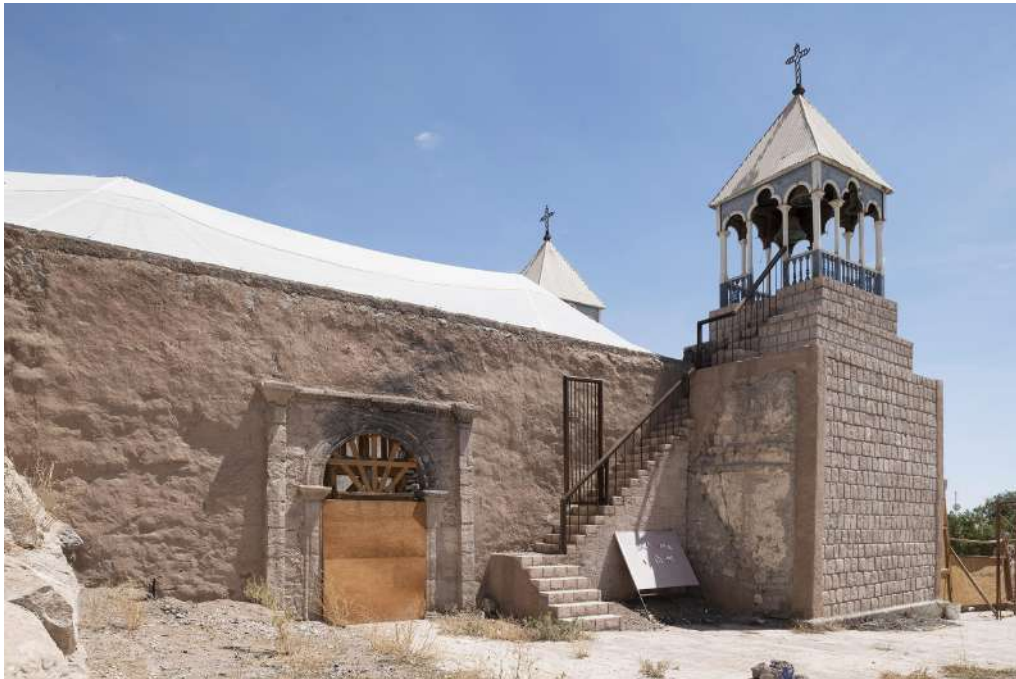
Imagen 6. Vista el muro evangelio y la torre campanario desde el exterior del templo.
