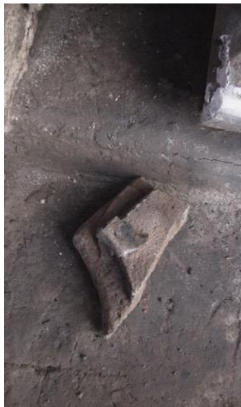
Desprendimiento de elementos del soporte
