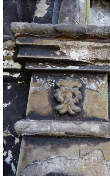
Acumulación de hollín
