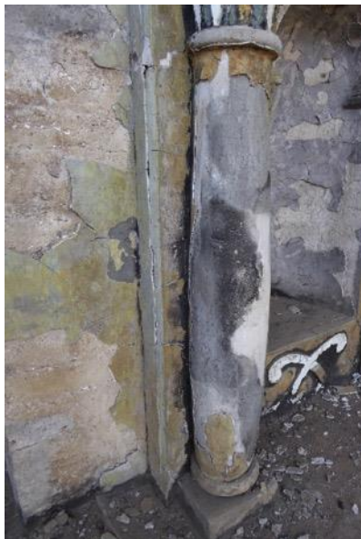
Manchas de hollín en la superficie
