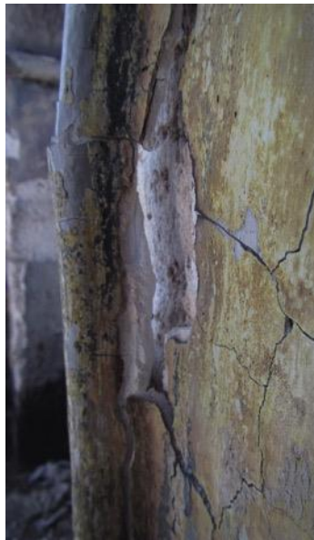
Desprendimiento de molduras
