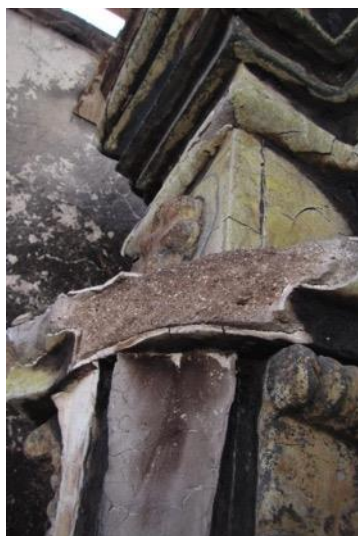
Fracturas con consiguiente pérdida
