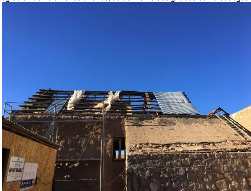
Sistemas constructivos deficientes e incompatibles con el valor patrimonial
