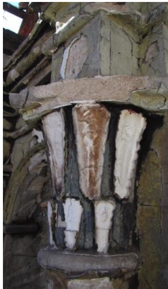
Pérdida de molduras
