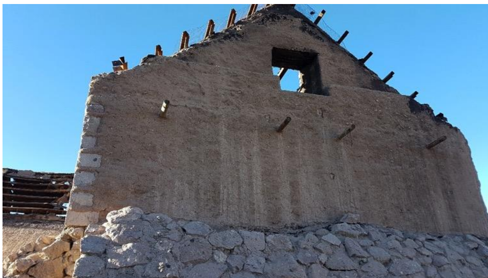
Desprendimiento y ausencia de revocos en el muro de la capilla del evangelio
