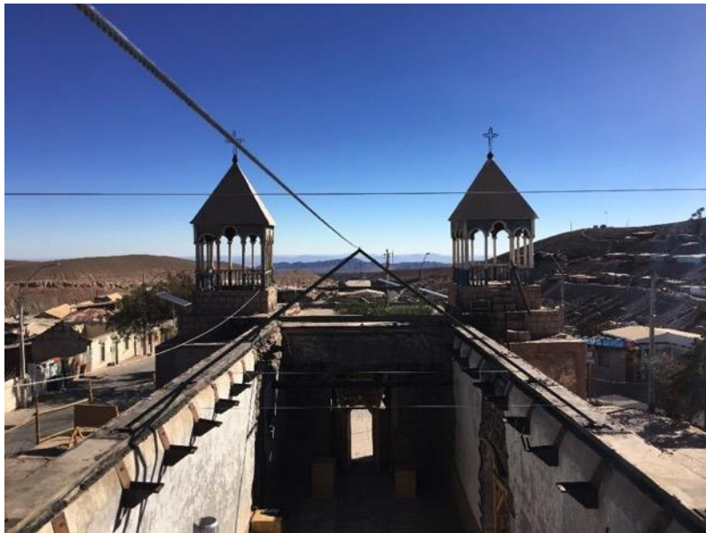
Pérdida de funcionalidad del inmueble
